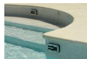
Ancrages de sécurité
